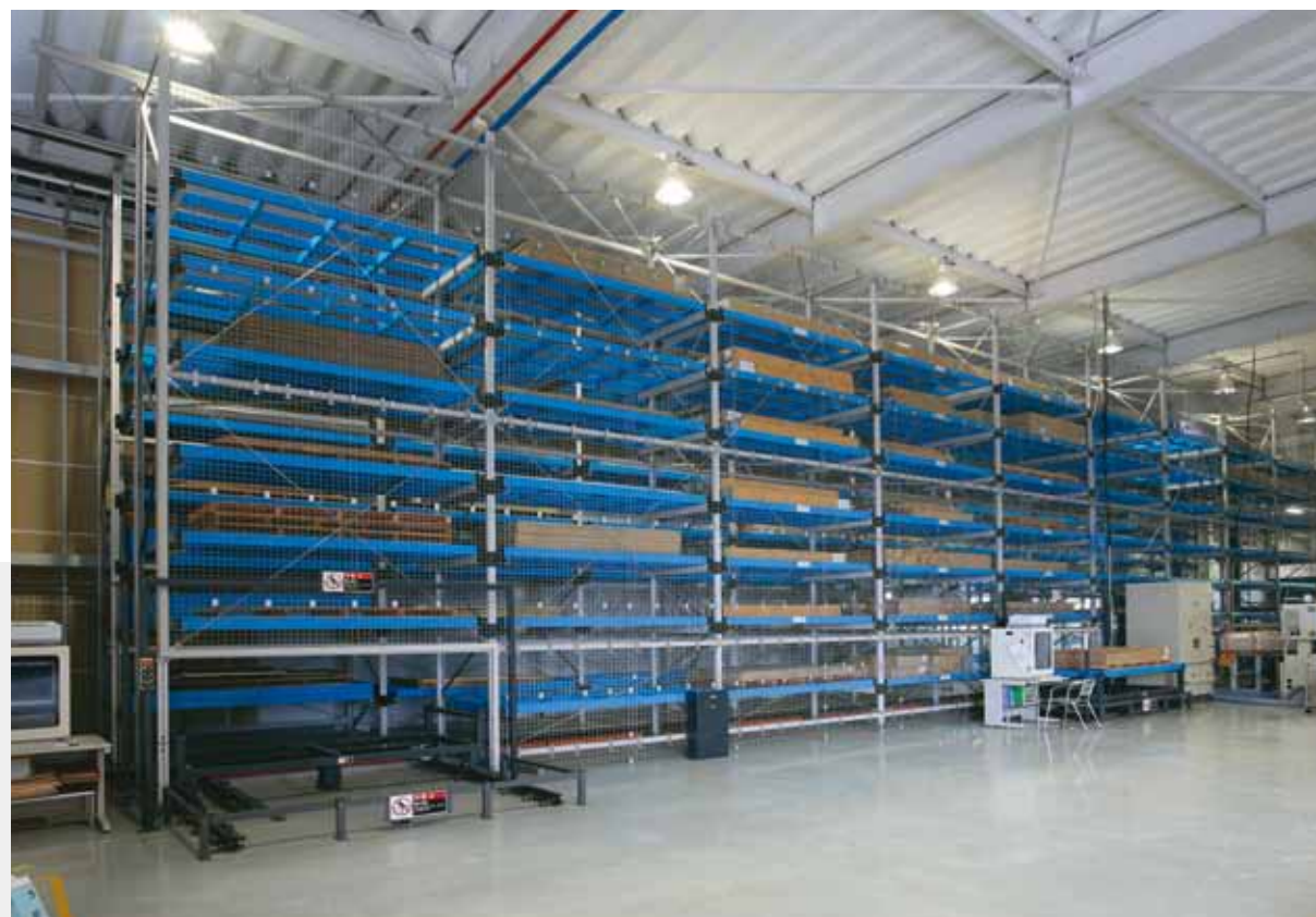
設置スペースを無駄なく活用し、入出庫・在庫管理をスムーズに行うことができる自動倉庫をSUSの拠点でいち早く導入した滋賀事業所。
