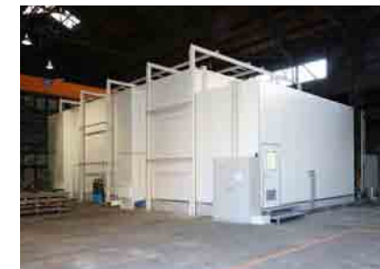
佃倉庫内に設置された植物工場専用プラント。空調が設備され、快適環境が整っている。
