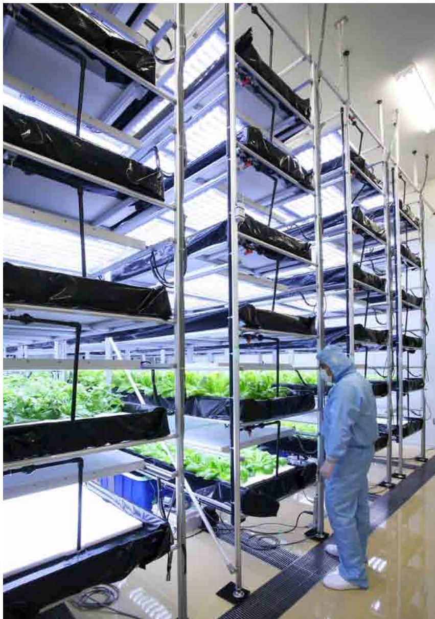
関西鉄工の植物工場プラント。4台の栽培棚すべてにアルミパイプ構造材GFが用いられている。
