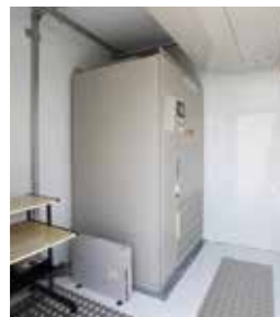
PCSシェルター内観 外部環境の影響を受けにくいエアコン内蔵型設計。
