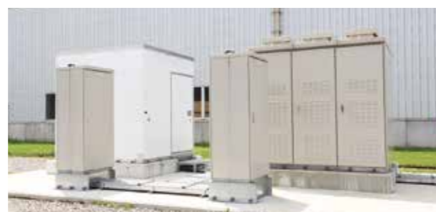
左奥の白いパネルがSUSのPCSシェルター。日東工業製品とのコラボレーション。
