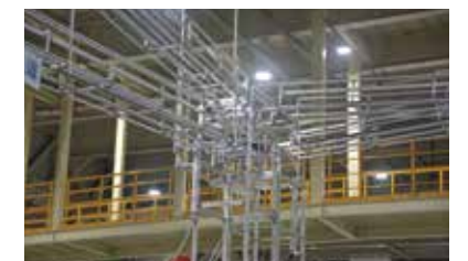
部品供給と空箱返送、上下に設置された2本のレーンにそれぞれ90度ターンの機構が組み込まれている。
