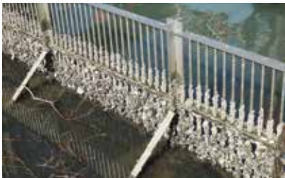
ゴミ除去スクリーンの斜め支柱
