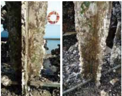
柱脚X8列下部の浸食の例
