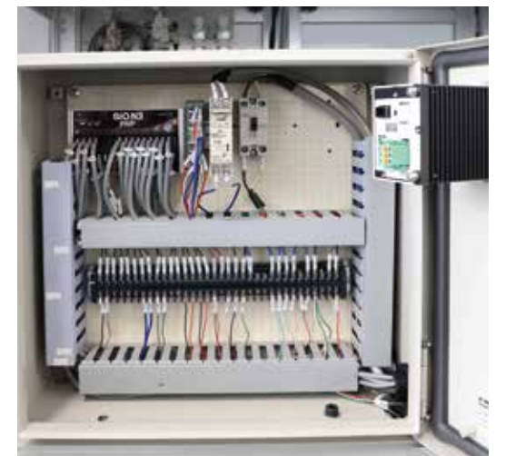
架台内の制御盤にはSiOが取り付けられており、MKグリップにエアを送るバルブ開閉など周辺機器の制御に使われている。
