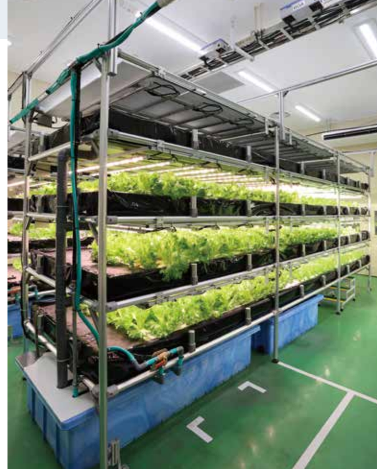
第2栽培室のGF製栽培棚の全景。配管やケーブルは足元の安全に配慮して床に下ろさず、頭上を通っている。
