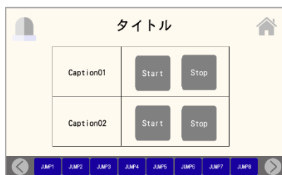
稼働・停止操作画面 （2個）
