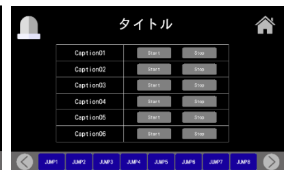
稼働・停止操作画面 (6 個)
